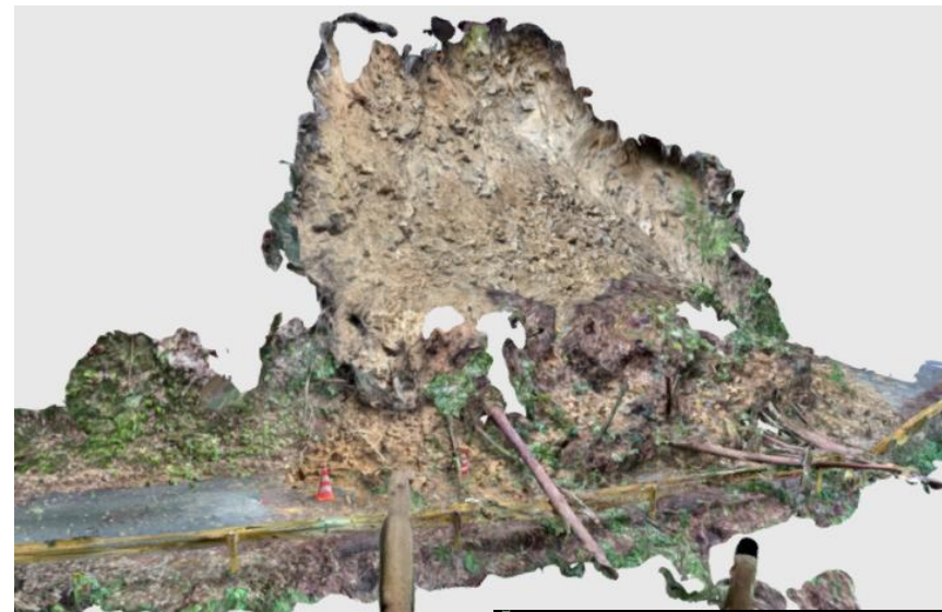
道路の崩落現場
