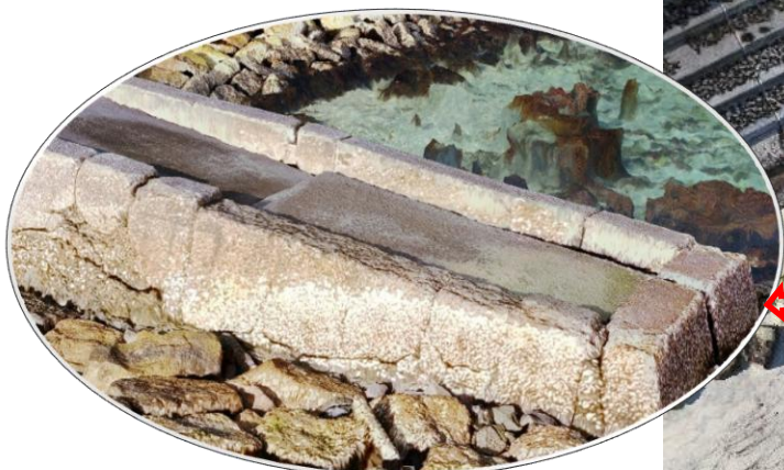
変状の状況（拡大）
